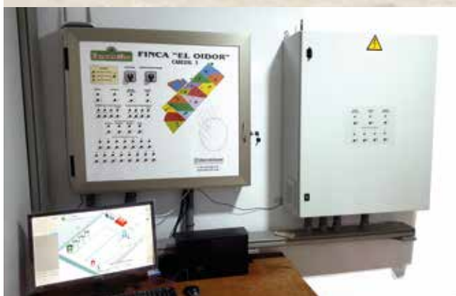
Cabezal de sistema de riego localizado de alta frecuencia. Permite realizar aportes precisos de nutrientes controlados por sistemas computacionales
